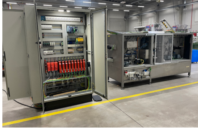
> De vernieuwde schakelkast in beeld.
